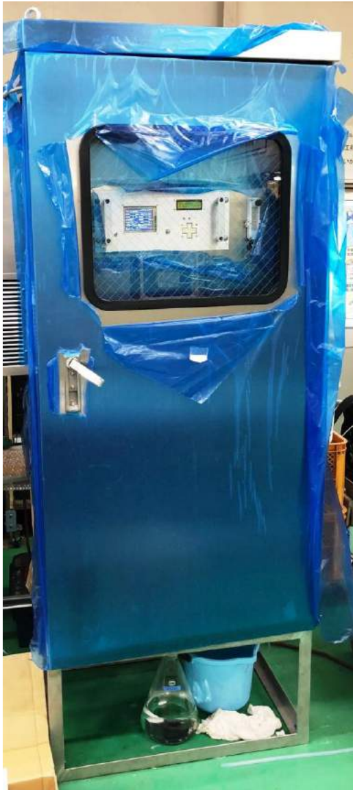
■水中VOCモニター盤 参考写真
